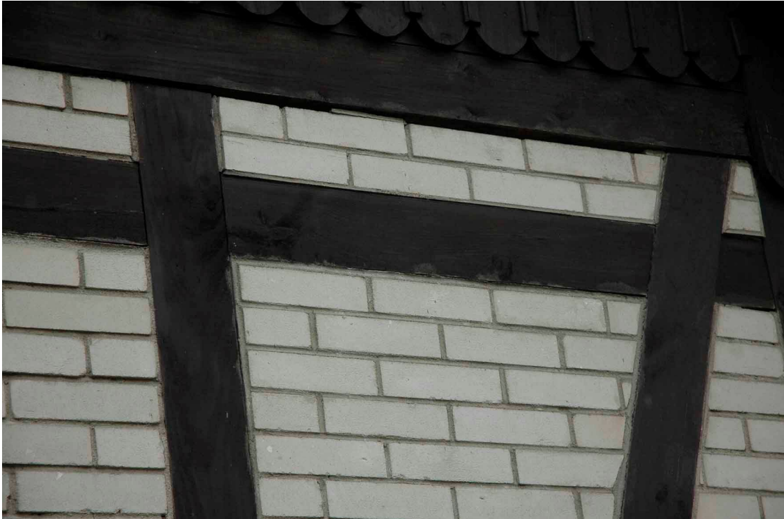
fot.45 Muzeum Inżynierii Miejskiej w Krakowie, budynek H, fragment elewacji północnej, widok: maj 2009
