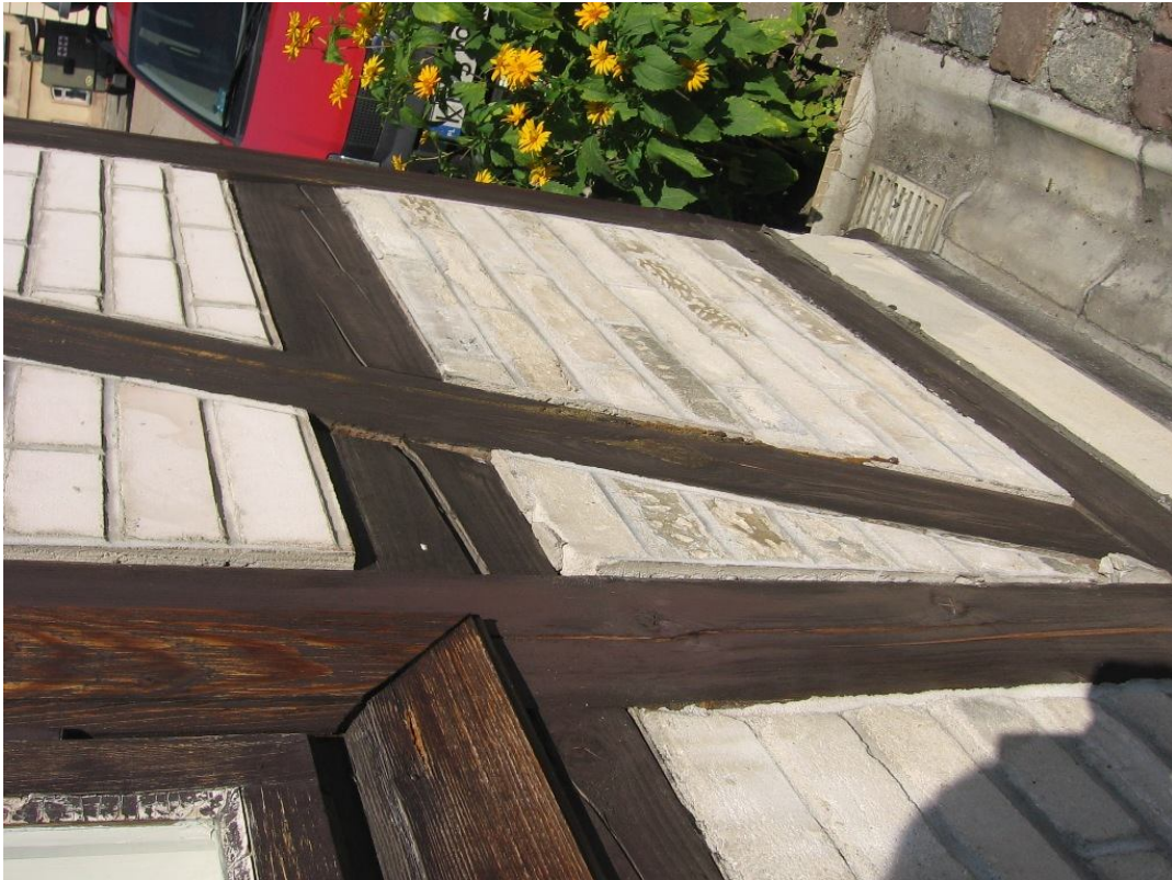
fot 25. Muzeum Inżynierii Miejskiej w Krakowie ul. św. Wawrzyńca 15 w Krakowie. Budynek H. Fragment wątku – stan obecny. Ruchomy (wypadający fragment wątku).
