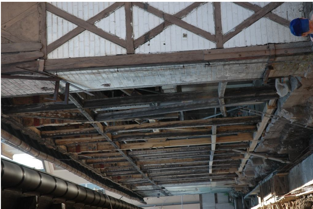
fot 12. Muzeum Inżynierii Miejskiej w Krakowie ul. św. Wawrzyńca 15 w Krakowie. Hala F. Stan konstrukcji drewnianej przed konserwacją.
