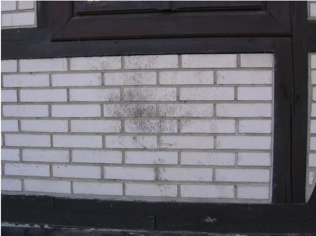
fot 24. Muzeum Inżynierii Miejskiej w Krakowie ul. św. Wawrzyńca 15 w Krakowie. Budynek H. Fragment wątku – stan obecny z widocznym zabrudzeniem mechanicznym.
