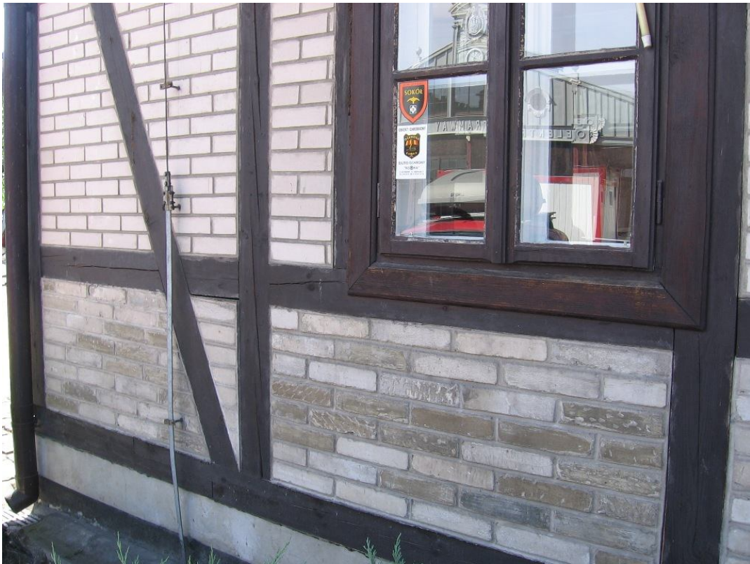
fot 23. Muzeum Inżynierii Miejskiej w Krakowie ul. św. Wawrzyńca 15 w Krakowie. Budynek H. Fragment wątku – stan obecny z widocznymi silnymi zabrudzeniami pow. cegły.
