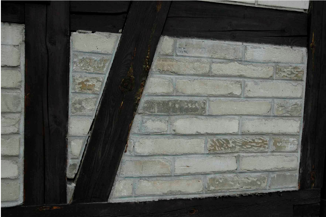
fol. 41 Muzeum Inżynierii Miejskiej w Krakowie, budynek H, fragment elewacji południowej, widok: maj 2009
