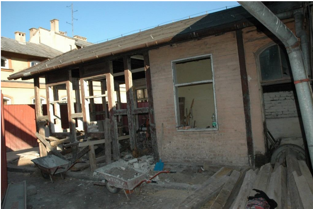
fot 11. Muzeum Inżynierii Miejskiej w Krakowie ul. św. Wawrzyńca 15 w Krakowie. Hala E – przybudówka. Stan konstrukcji drewnianej przed konserwacją.
