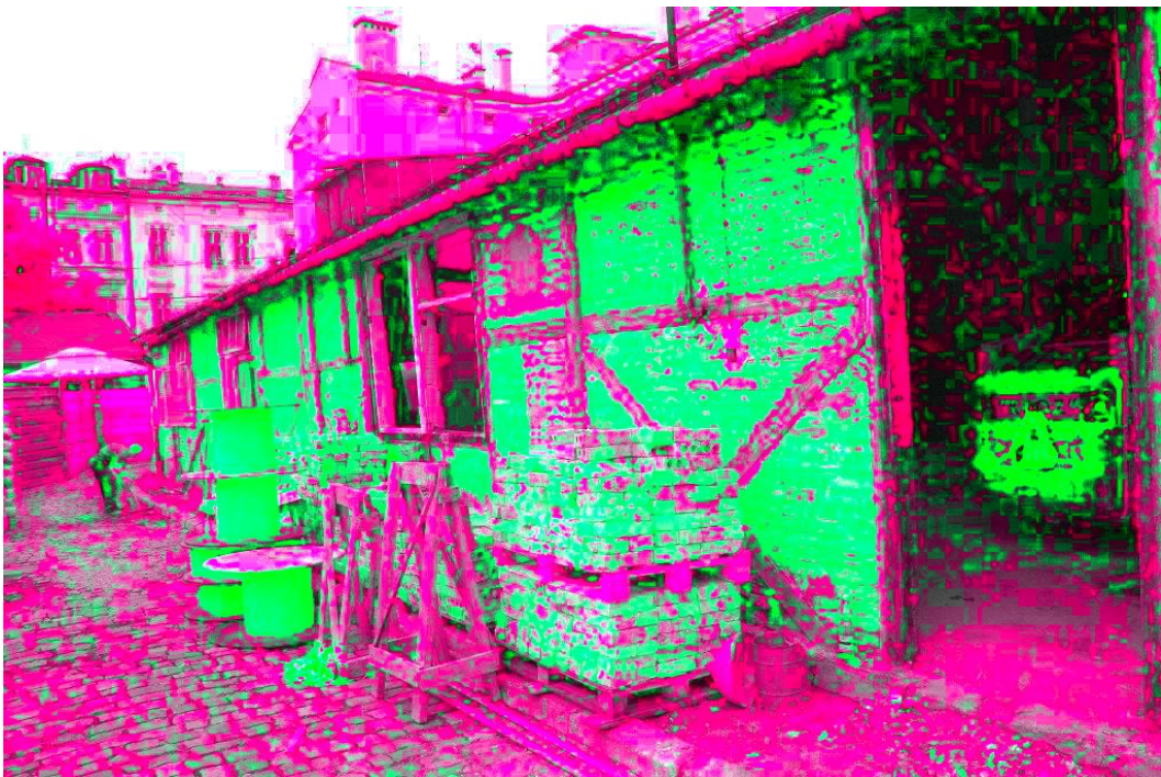
fot 2. Muzeum Inżynierii Miejskiej w Krakowie ul. św. Wawrzyńca 15 w Krakowie. Hala E – ściana południowa. Stan przed konserwacją.
