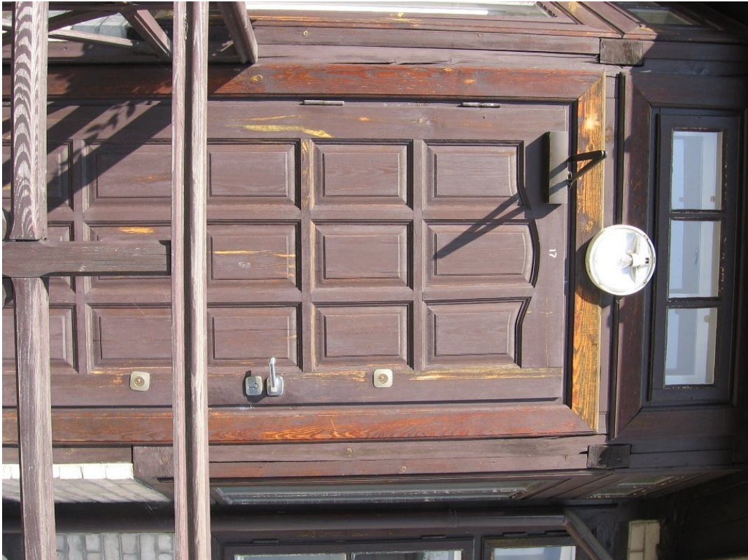
fot 26. Muzeum Inżynierii Miejskiej w Krakowie ul. św. Wawrzyńca 15 w Krakowie. Budynek H. Obecny stan stolarki – drzwi.
