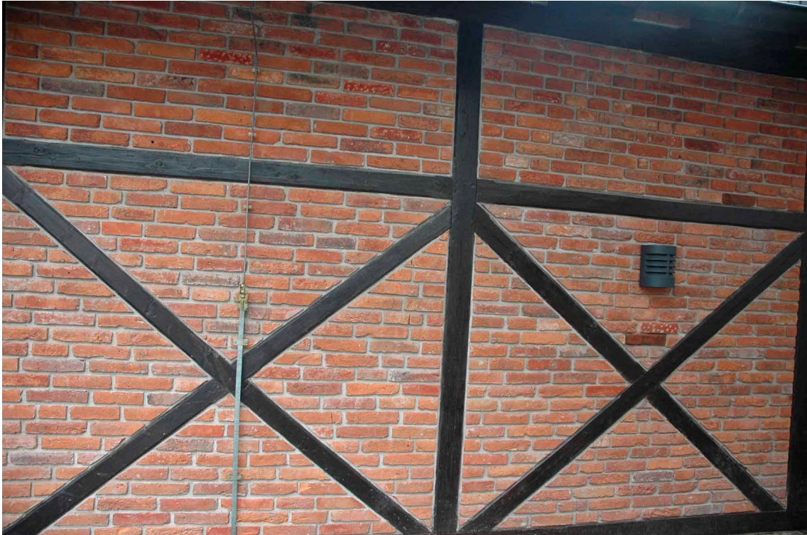
fol. 35 Muzeum Inżynierii Miejskiej w Krakowie, hala E, fragment elewacji północnej, widok: maj 2009
