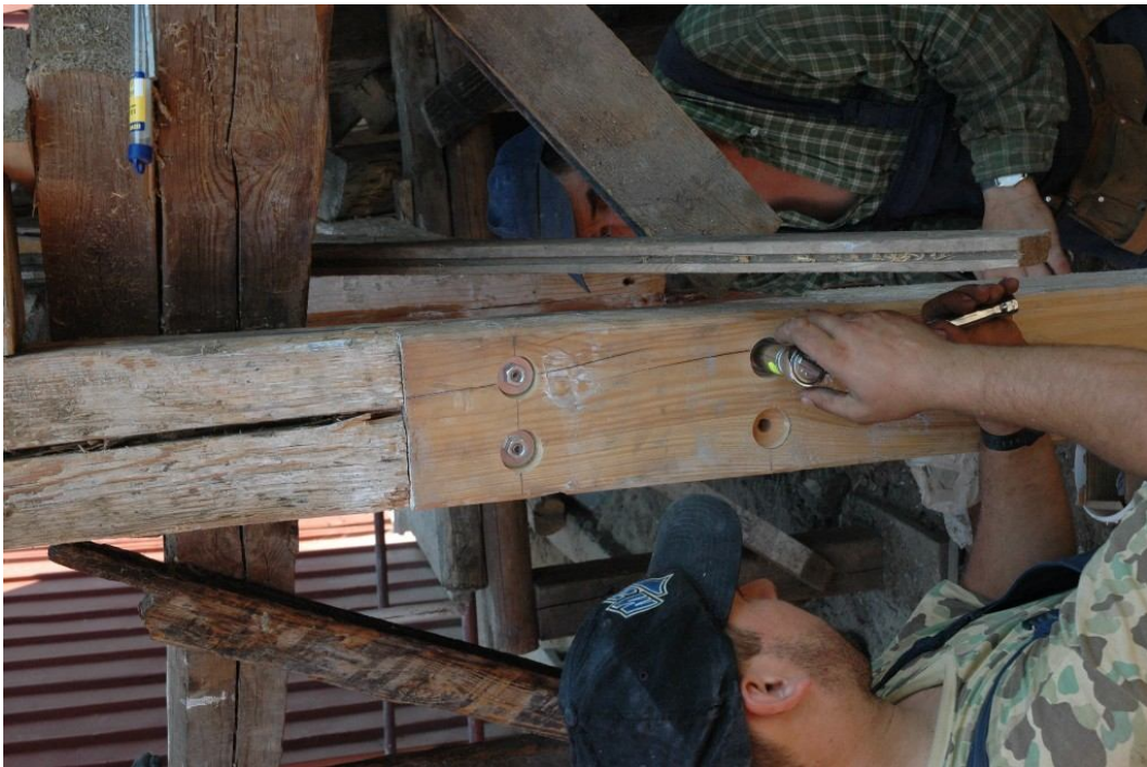
fot 13. Muzeum Inżynierii Miejskiej w Krakowie ul. św. Wawrzyńca 15 w Krakowie. Hala E . Montaż wymienionego fragmentu konstrukcji drewnianej.
