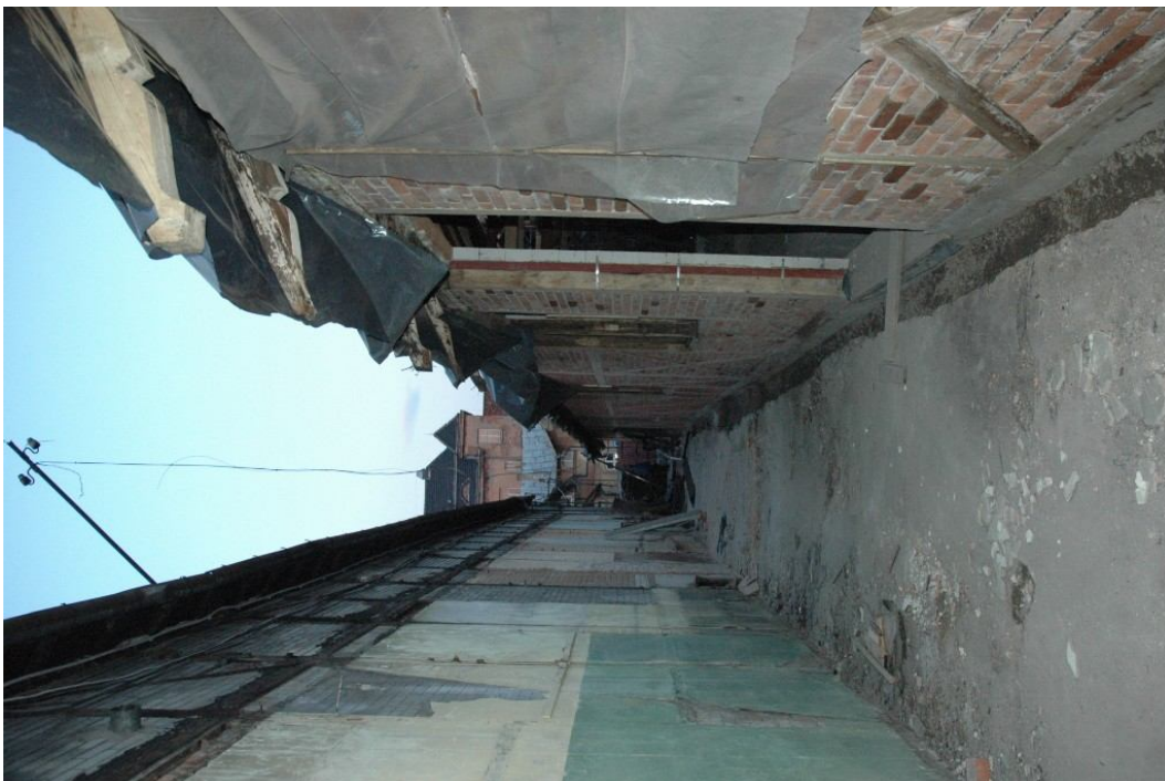
Fot4. Muzeum Inżynierii Miejskiej w Krakowie ul. św. Wawrzyńca 15 w Krakowie. Hale E i F – elewacje północna i południowa. Stan przed konserwacją.
