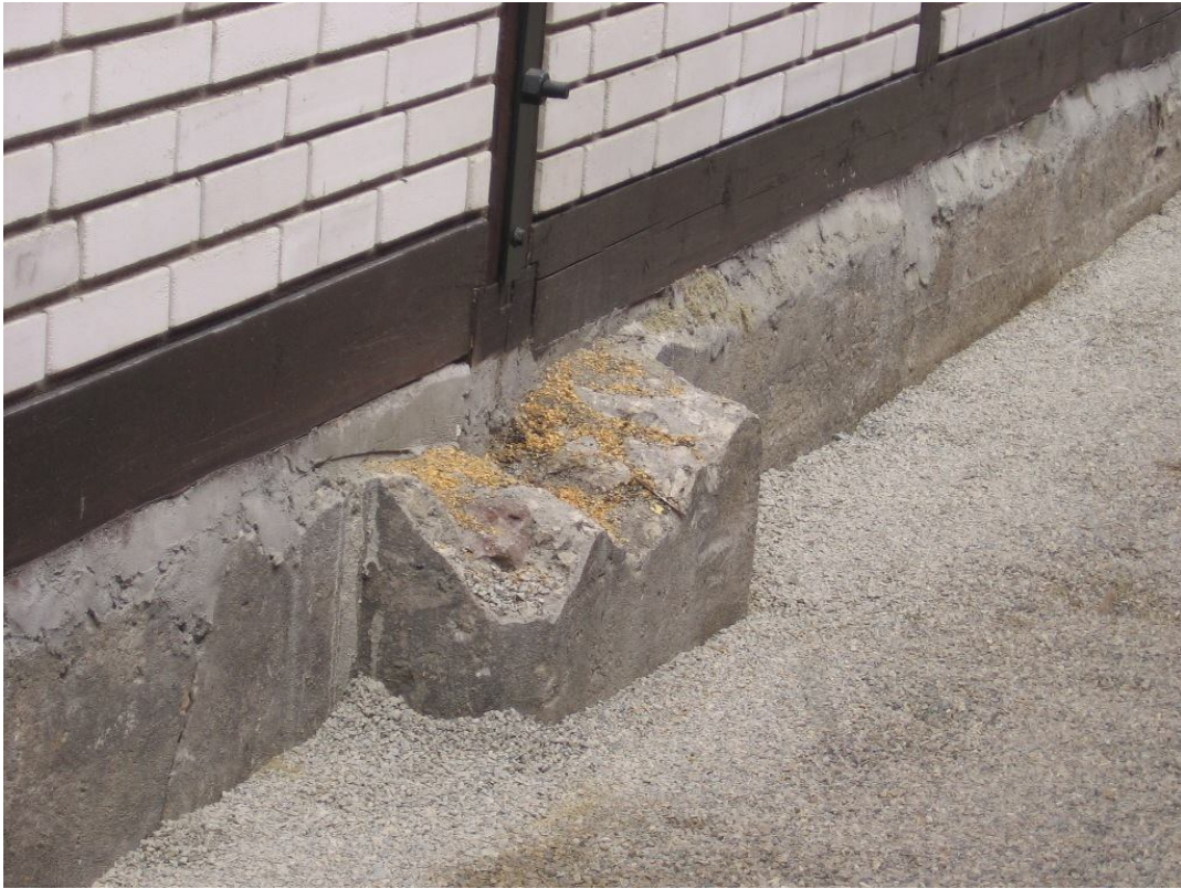
fot 21. Muzeum Inżynierii Miejskiej w Krakowie ul. św. Wawrzyńca 15 w Krakowie. Hala F. Partia przyziemia – stan obecny.
