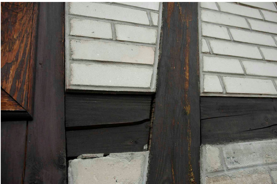
fot.48 Muzeum Inżynierii Miejskiej w Krakowie, budynek H, fragment elewacji południowej, widok: maj 2009
